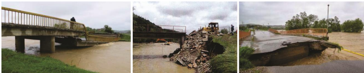
Slika 1. Oštećeni mostovi u poplavama 2014. godine; sleva udesno, lokaliteti: Koceljeva (r. Tamnava), Ljig (r. Ljig), Draginac (r. Jadar) [25].
