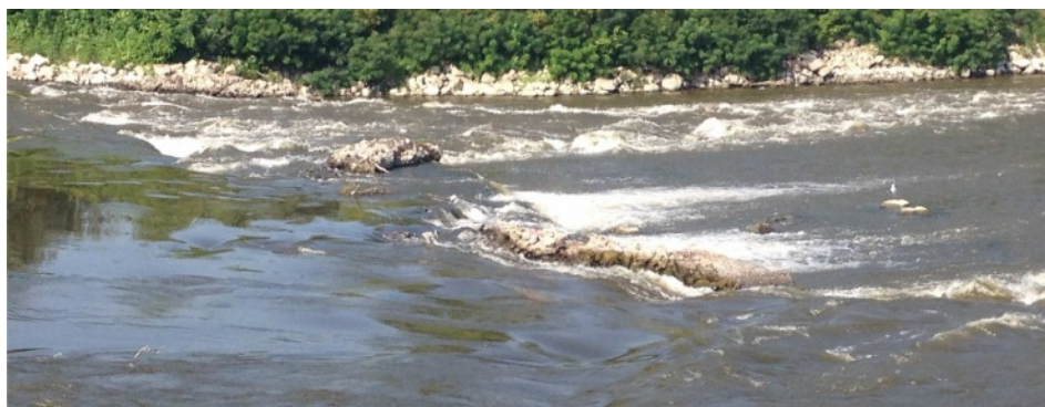
Slika 3.12: Velika Morava: ostaci gabionskog madraca zgužvanog udarom balvana.
