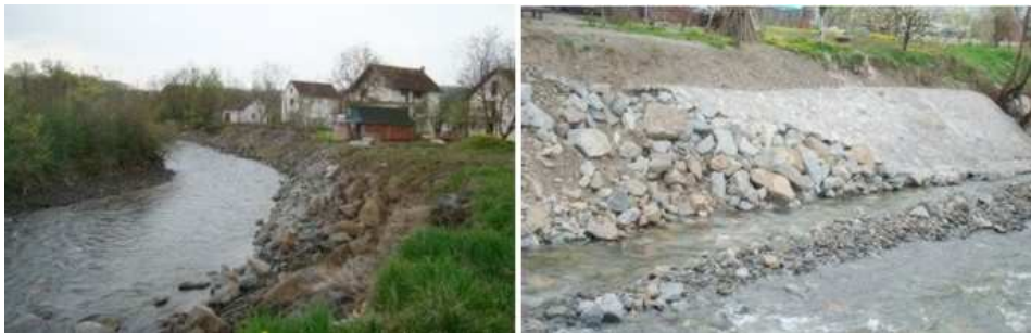
Slika 3.34: Obaloutvrde na reci Ribnici; na deonici sa kamenim nabačajem (levo), obaloutvrda je u toku poplave 2014. god. pretrpela male deformacije; kruta obloga od zalivenog kamena (desno) je propala usled ispiranja filtra i obrušavanja nožice.
